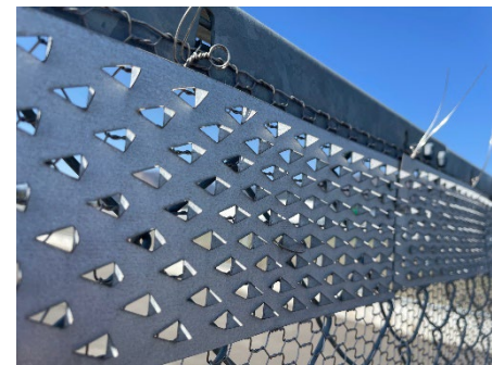
右下：フェンス上部にある、ネズミの侵入防止有刺プレート。
